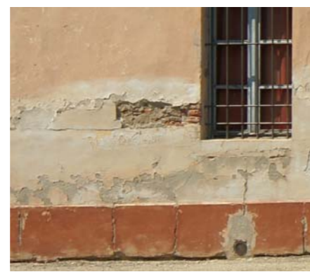
Fotografia dell'umidità di risalita
